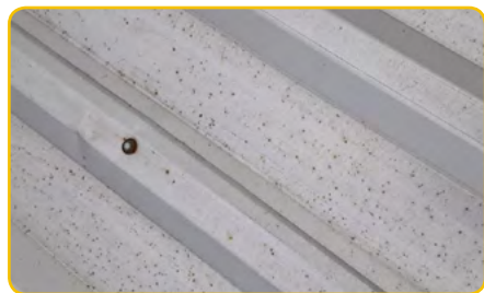
Oxidação gerada pela limalha
